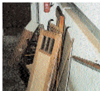
Fatal im Brandfall: abgestellter Sperrmüll in Fluchtwegen
